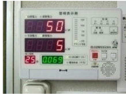
(デマンド監視装置)
