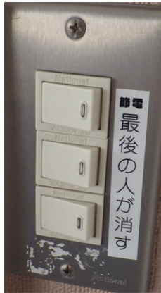
消灯を促すシールの貼付
